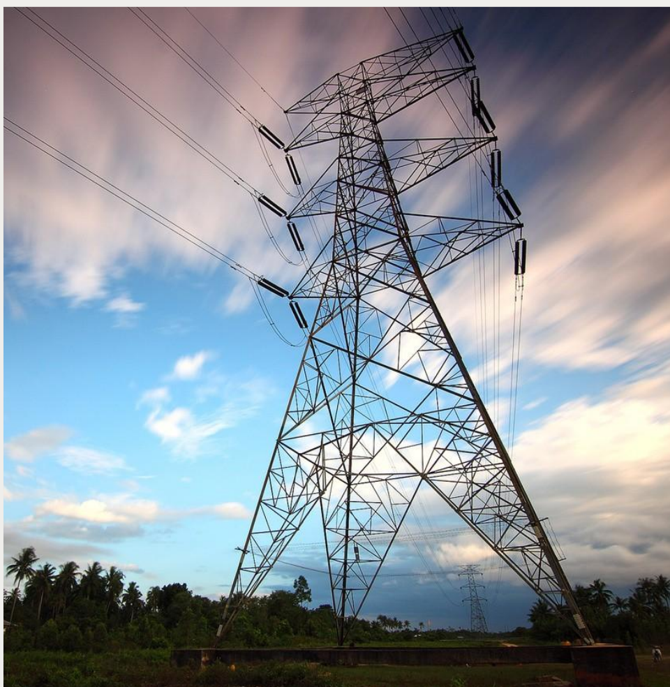
Figura 1 – Torre de linha de transmissão de energia elétrica.
