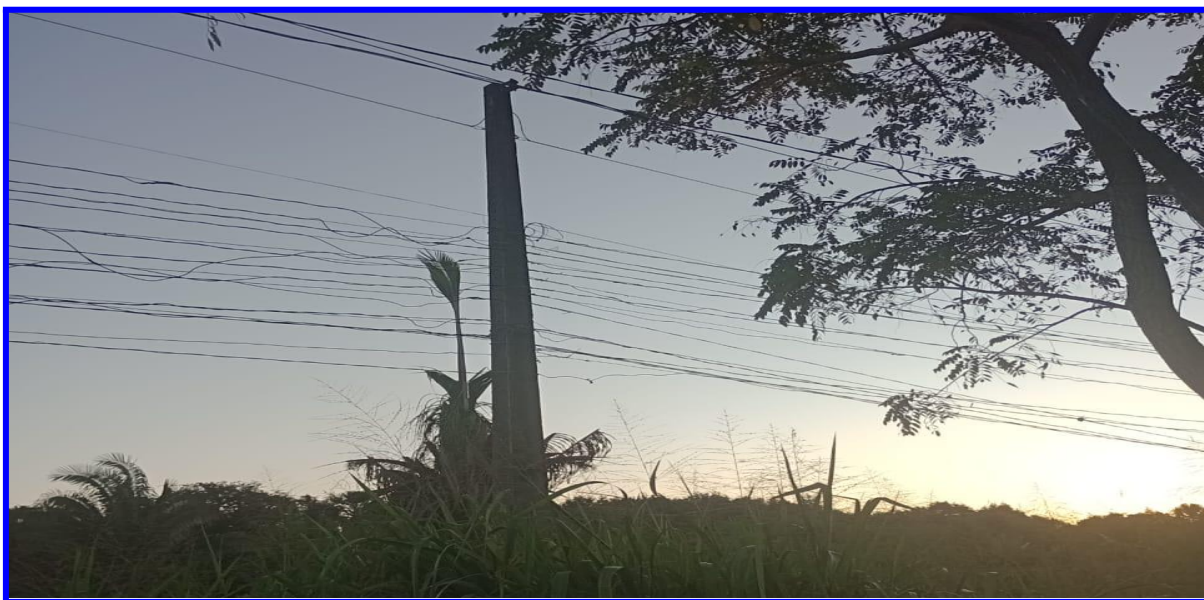
Figura 13: Ligação clandestina de energia elétrica na comunidade Jardim Deus é Fiel
