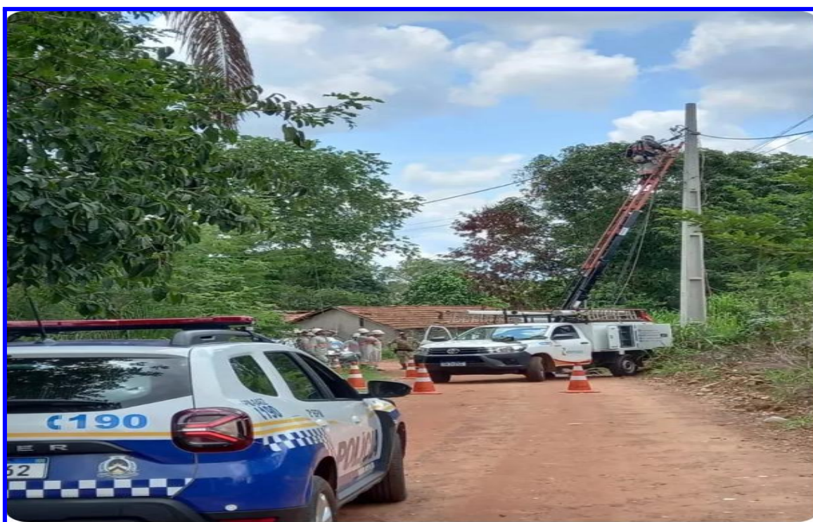
Figura 12: Energisa com escolta policial em desligamento clandestino de energia, de Comunidade Jardim Deus é Fiel em 26 de Novembro 2024
