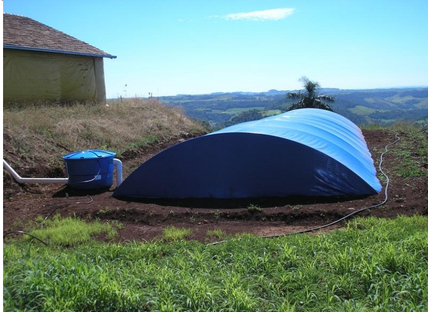
Figura 22- Cisterna de lona para captação de água da chuva
